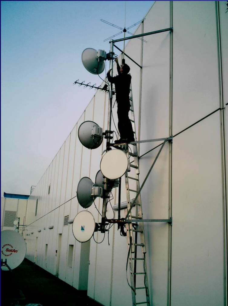
Westseite/ südliche Antennenhalterung:
